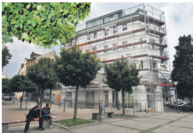
Das Haus am Flensburgerplatz stand jahrelang leer und drohte komplett zu verfallen. Jetzt wird's renoviert. Foto: Ralf Rottmann
